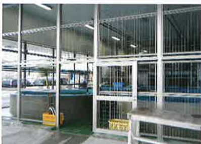
荷捌き施設に隣接した活魚水槽
